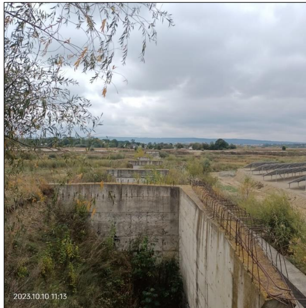
Figure 43. Lucrările abandonate la podul Talpa
